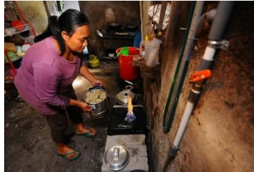
Gambar 6. Instalasi sistem utilitas biogas pada dapur rumah warga
