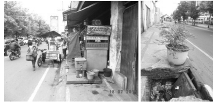
Gambar 1. Kondisi jalur pedestrian di Jl. Stasiun Kereta Api Medan
