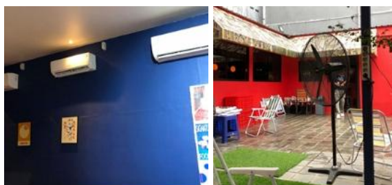
Gambar 13. Penghawaan Buatan pada Lafera Space Sumber : dokumentasi penulis, 2025
