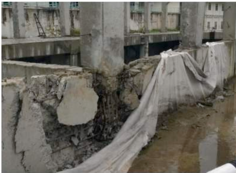
Gambar 3. Kerusakan Struktur Reservoir akibat Gaya Uplift
