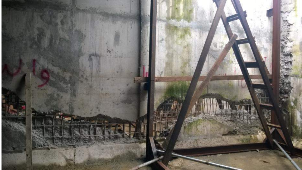
Gambar 4. Kerusakan pada Dinding Bangunan
